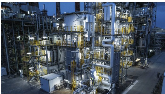
Elektrocracker bei BASF: Hier wird die Heizenergie künftig elektrisch bereitgestellt.
